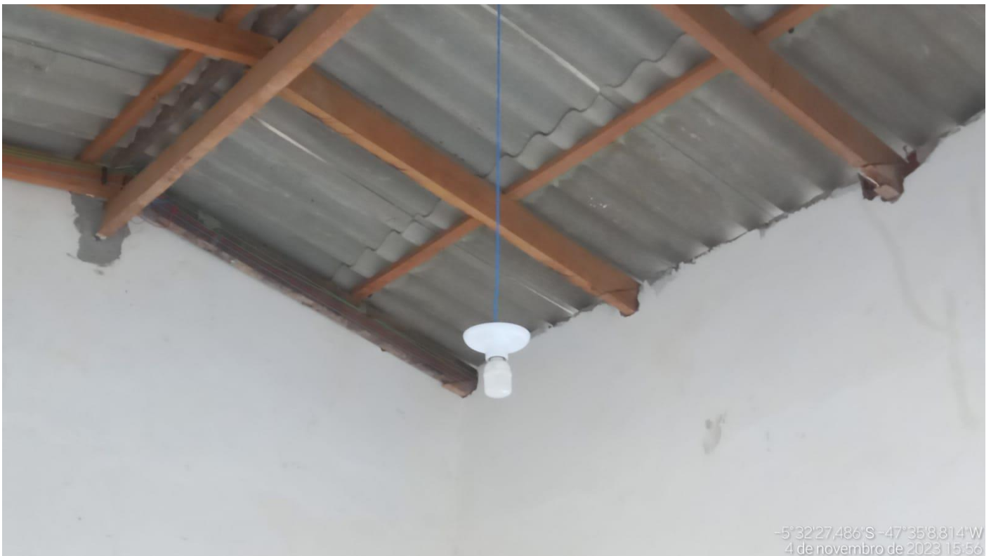
Figura 10 - LAMPADA DE LED 30 W INSTALADA EM AMBIENTE INTERNO.
