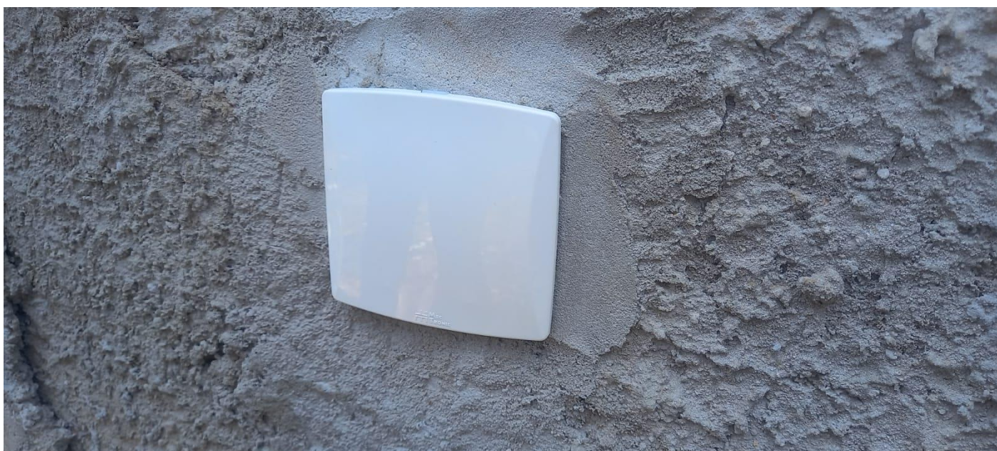
Figura 4. CAIXA DE PASSAGEM EM PAREDE EXTERNA COM TAMPA CEGA.
