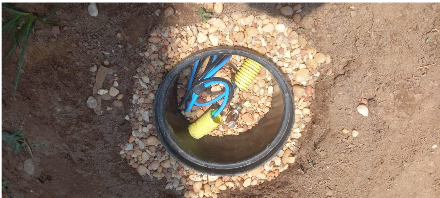
Figura 1 - CAIXA DE ATERRAMENTO E PASSAGEM, COM CABOS ELÉTRICOS DE LIGAÇÃO 10 MM 2 E HASTE DE ATERRAMENTO 2,00 M DE COMPRIMENTO.
