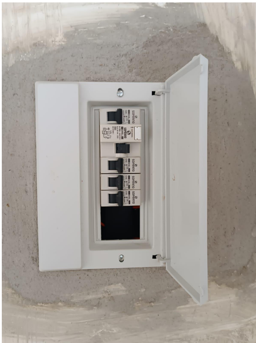
Figura 11. QUADRO DE DISTRIBUIÇÃO, COM TODOS OS DISJUNTORES APÓS FINALIZAÇÃO.
