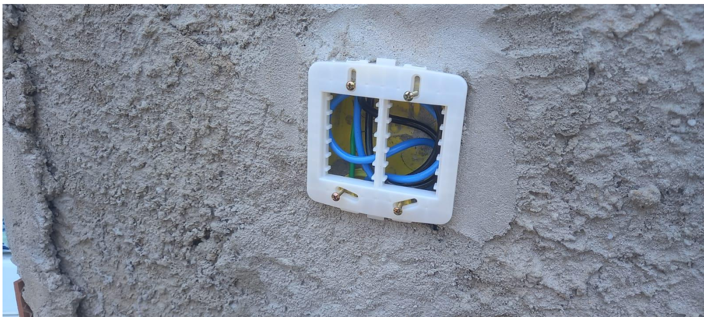
Figura 3 - CAIXA DE PASSAGEM 4X4 EM PAREDE EXETERNA PARA PASSAGEM DE CABOS DE LIGAÇÃO E ATERRAMENTO.
