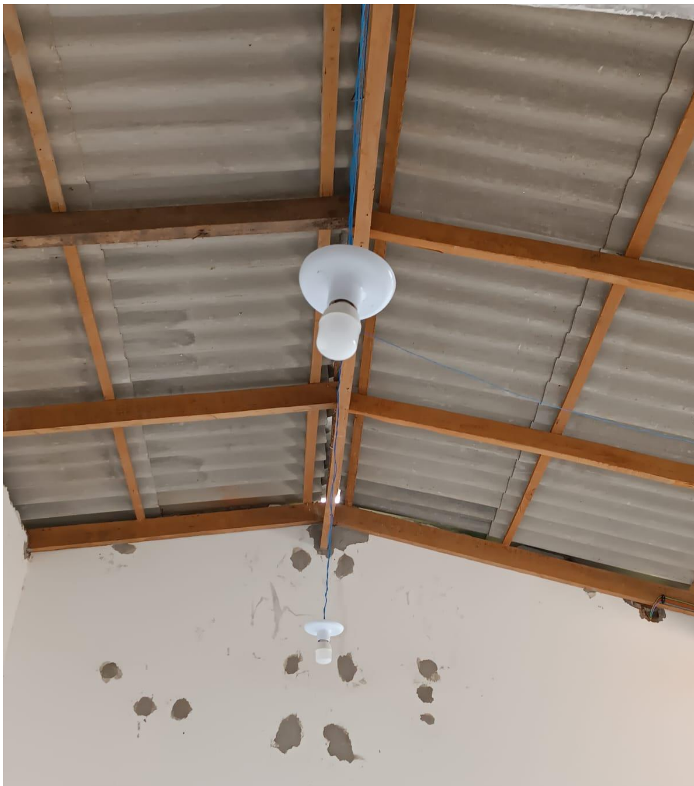
Figura 8 - LAMPADAS DE 30 W TIPO BULBO COM PLAFON PLASTICO EM TODOS OS AMBIENTES, CABOS ELÉTRICOS DE 1,5 MM2 NO CIRCUITO DE ILUMINAÇÃO.
