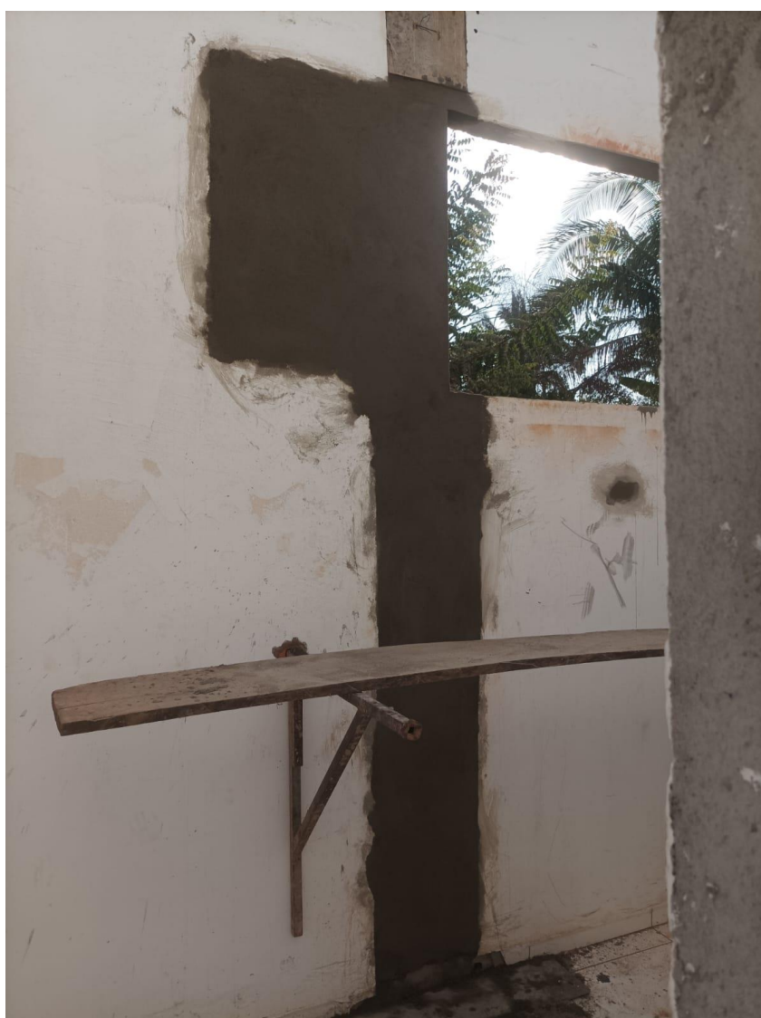
Figura 11 - massa única, para recebimento de pintura, em argamassa traço 1:2:8, aplicada manualmente em faces internas de paredes, espessura de 20mm
