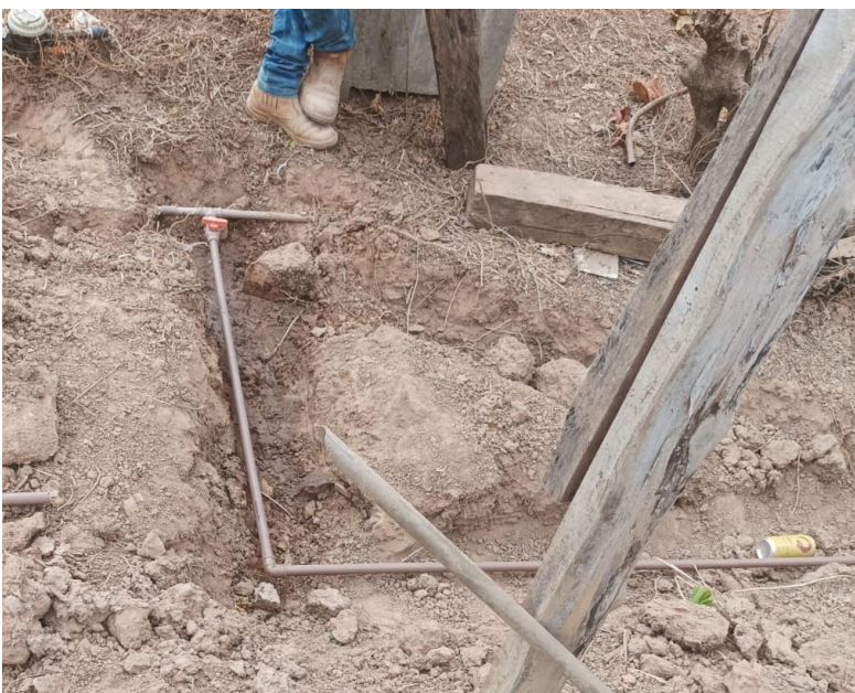
Figura 6 tubos de pvc, soldável, água fria, dn 20 mm (instalado - ramal de abatecimento do reservatório)
