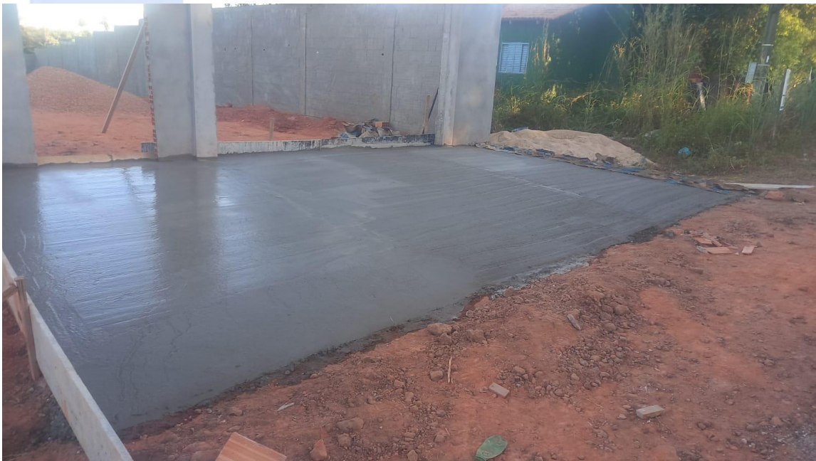
Figura 7 - Execução de rampa em concreto em frente a entrada de veículos, lateral direita da fachada.
