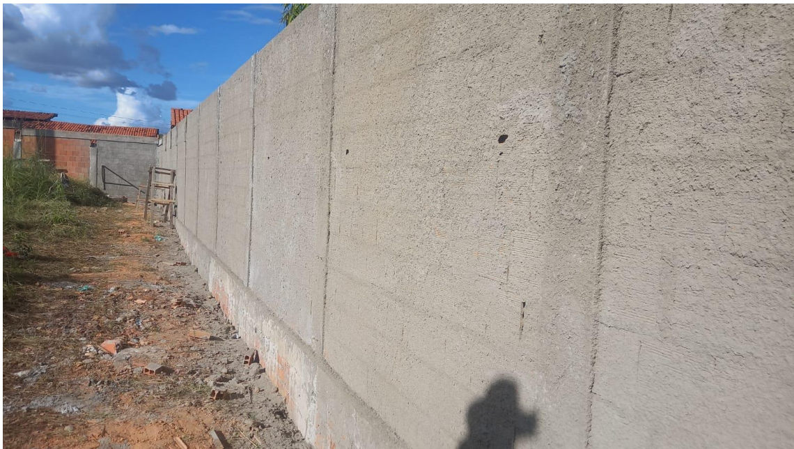
Figura 4 - Chapisco traço 1:3 aplicado com colher de pedreiro em muro de divisa, pano de parede interna.
