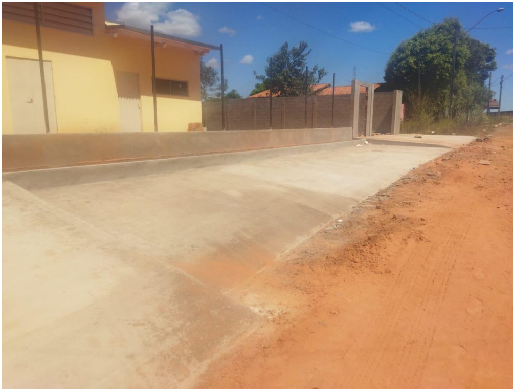
Figura 8 - Execução de pátio em concreto em frente a entrada de veículos e estacionamento, fachada da edificação.
