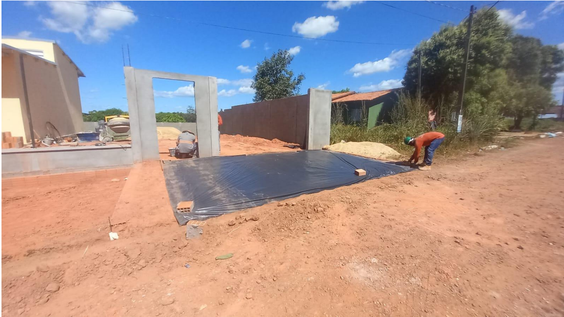
Figura 6. Instalação de lona plastica para execução de pátio em concreto na fachada.
