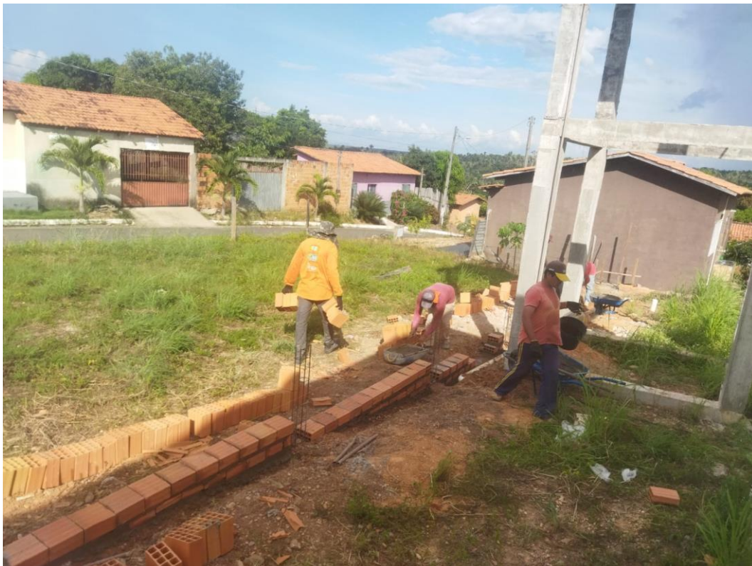
Figura 8. execução de alvenaria de embasamento em degraus conforme desnível do terreno natural.
