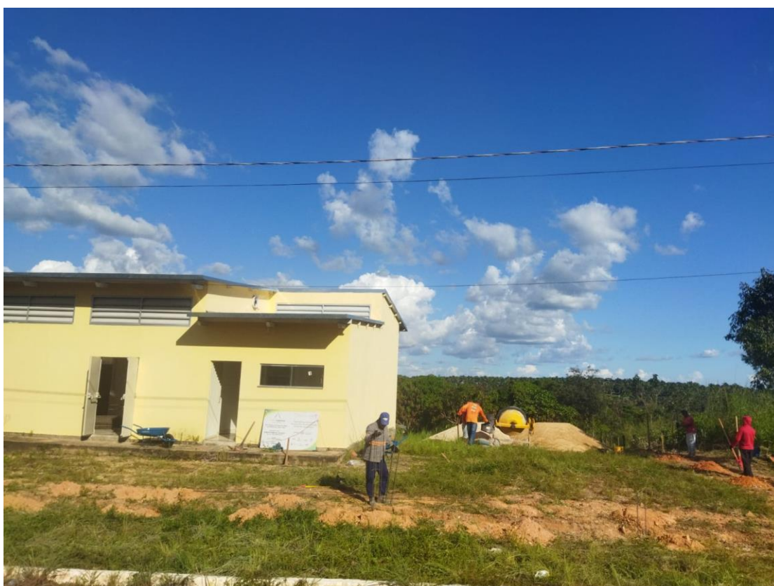
Figura 1. SERVIÇOS PRELIMINARES DA OBRA DE CONSTRUÇÃO DO MURO DE DIVISA DO ENTREPOSTO DO BABAÇU.
