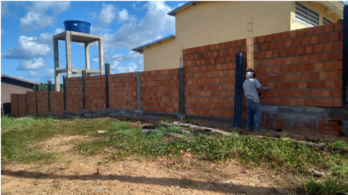
Figura 11. montagem e desmontagem de formas de pilares na lateral esquerda do muro.
