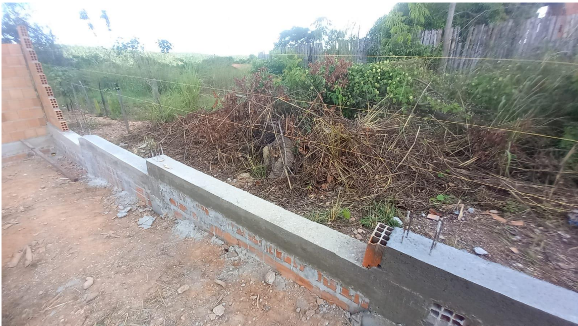
Figura 3. viga baldrame concreta e pronta para receber alvenaria de vedação, lateral direita do terreno.
